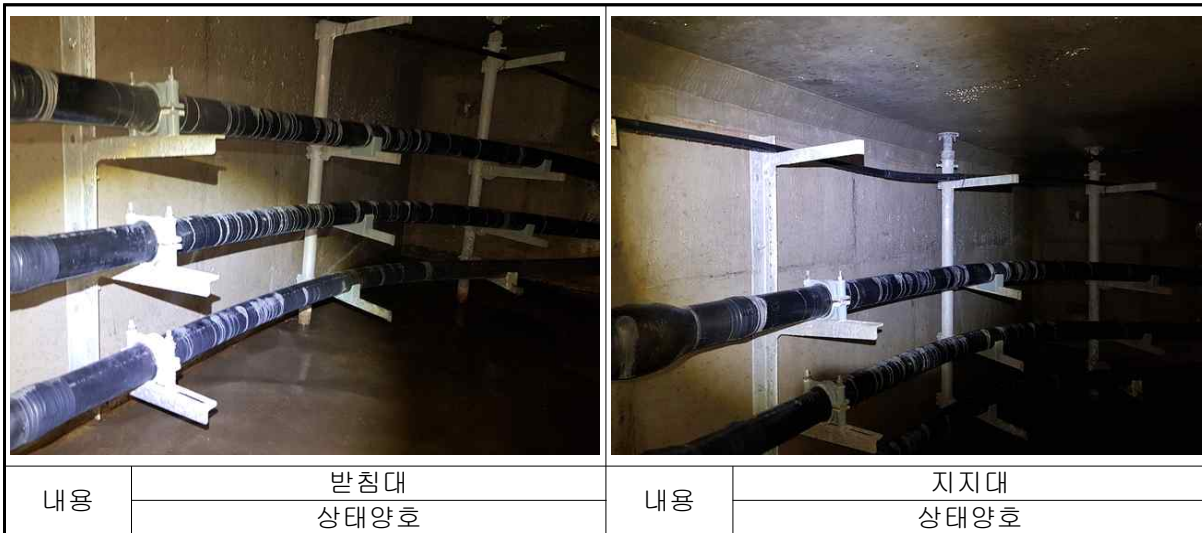
【사진 5.12】 부속 및 부대설비 현황
