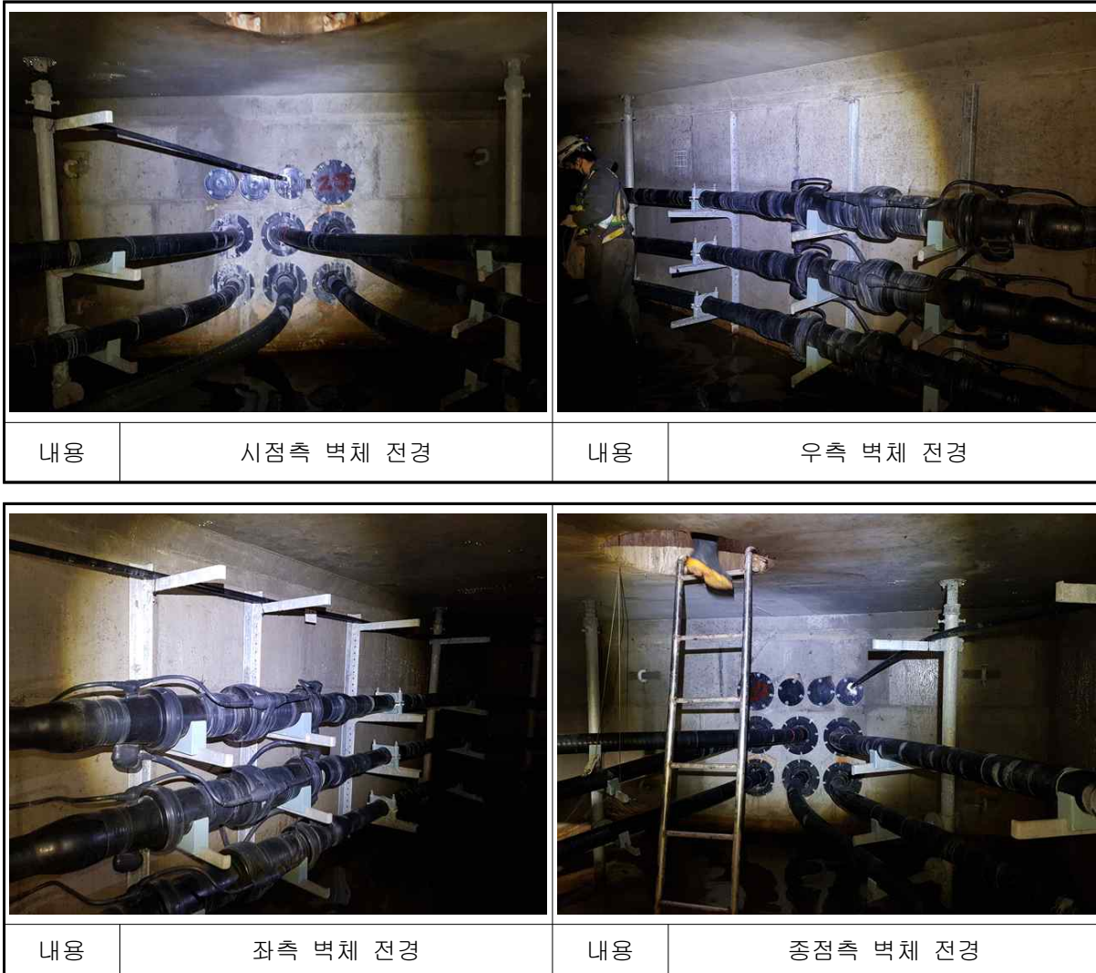
【사진 5.9】 신덕은~문산 #3 전경
