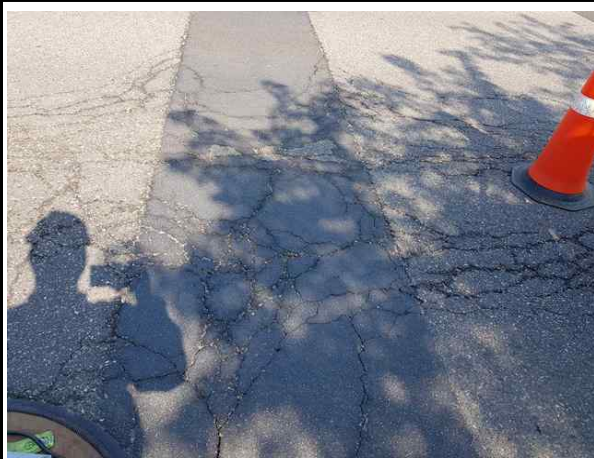
내용 신덕은~문산 #1 아스콘망상균열
