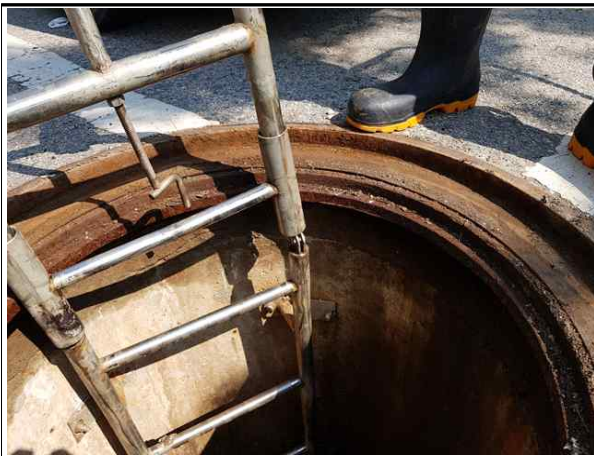
내용 신덕은~문산 #3 안전손잡이볼트탈락
