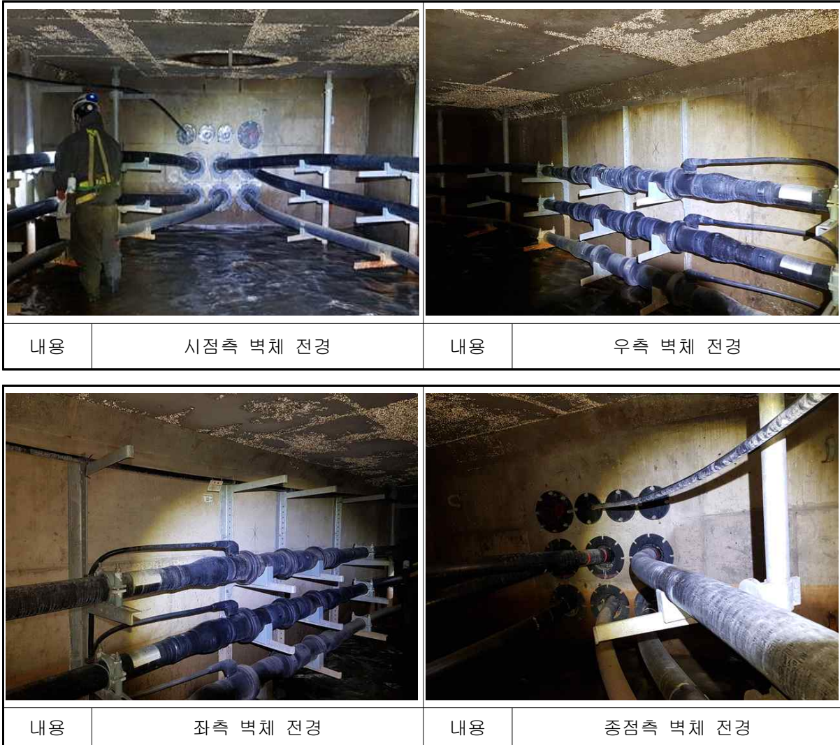
【사진 5.5】 신덕은~문산 #2 전경
