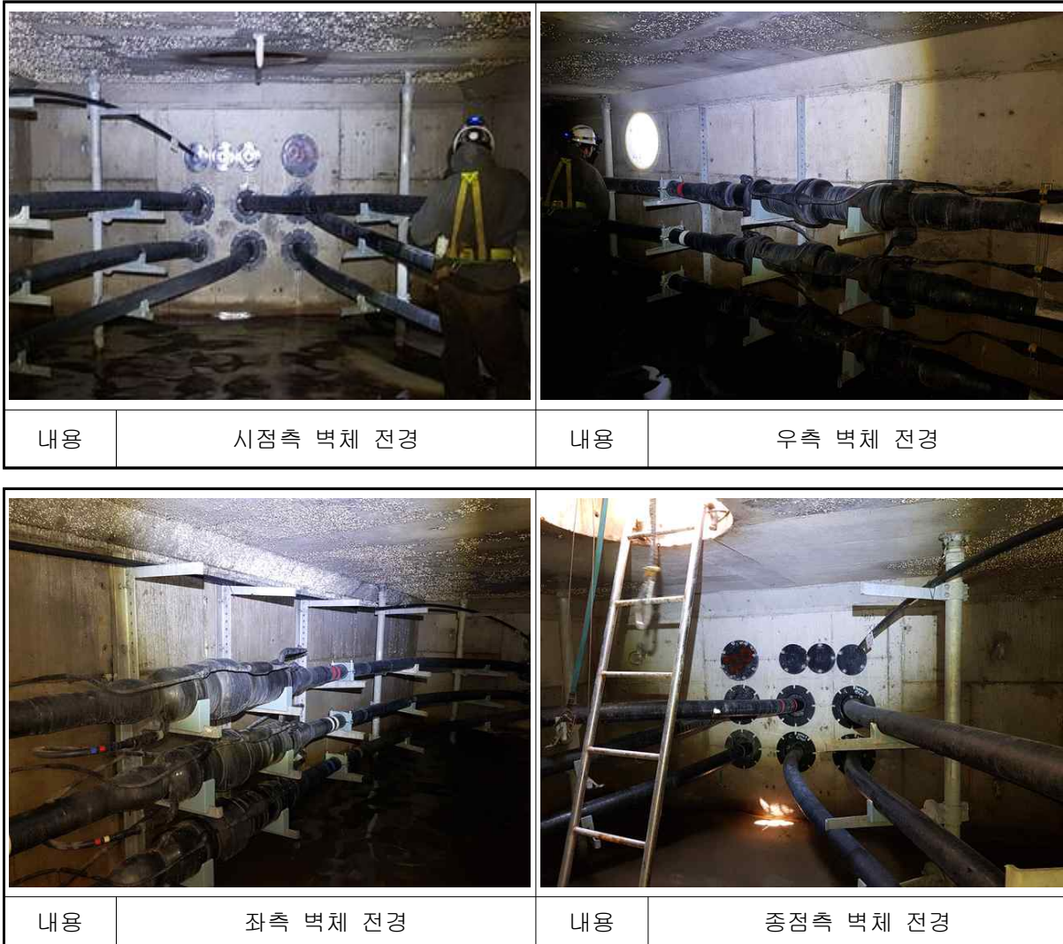
【사진 5.13】 신덕은~문산 #4 전경
